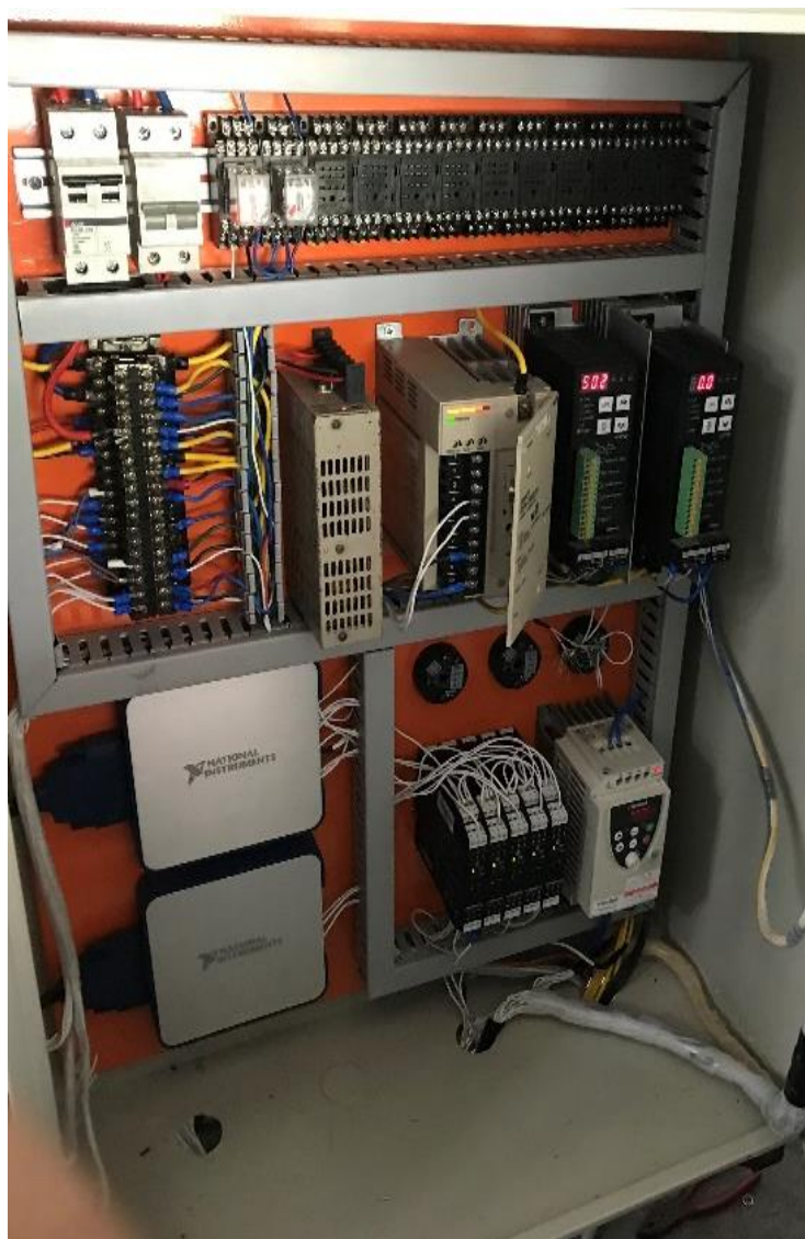
Hình 5.17 Thiết bị điều khiển tháp chưng cất Ethanol và Nước
